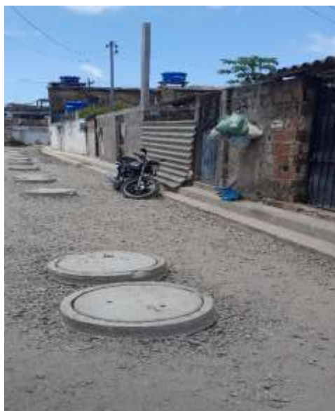
Figura 1: Caixa de Inspeção e Ramal Predial.
